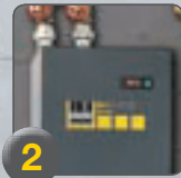
2 Подготовка сжатого воздуха
